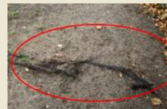
Offene Wurzeln auf Gehweg
