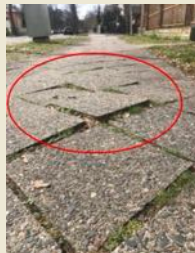
Baumwurzeln heben die Pflasterplatten
